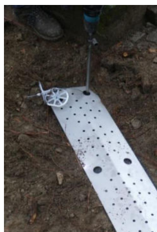
Abb. 22 – 23. Das Wurzelschutzblech wird auf die Bautenschutzmatte aufgelegt. Nach dem Sondieren der Einpresslöcher werden die vier Erdanker mittels Vortriebsstange bis 1,50 m Tiefe eingerammt.
